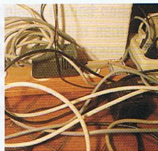
3 Die Stromversorgung einer Computeranlage will organisiert sein
