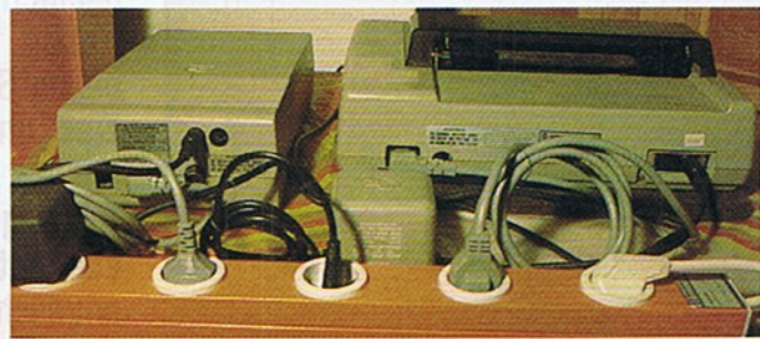
2 Unterbringung der Netzstecker auf einer Steckerleiste
